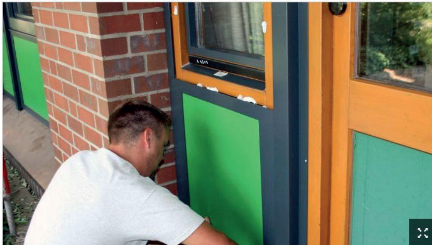
Einer der Arbeiter klebt eine Aluplatte auf einen Holzrahmen am Veterinäramt. - Fotos: bor
